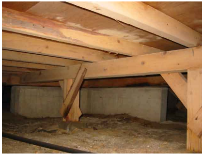
床下点検 束石が不十分
